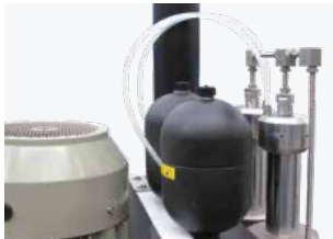
Acumulador de nitrógeno para la gestión del circuito de retorno de los cilindros hidráulicos
